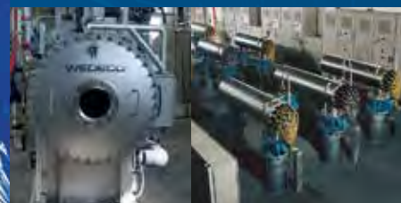
Ossidazione con Ozono e disinfezione UV Wedeco
