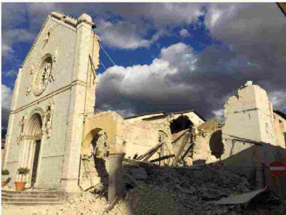
Basilica di San Benedetto dopo il terremoto
