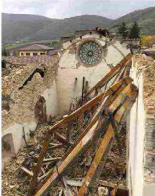
Chiesa di San Francesco dopo il terremoto
