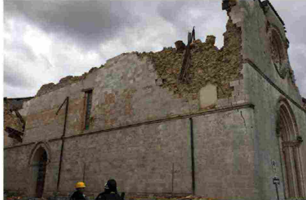
Chiesa di San Francesco dopo il terremoto
