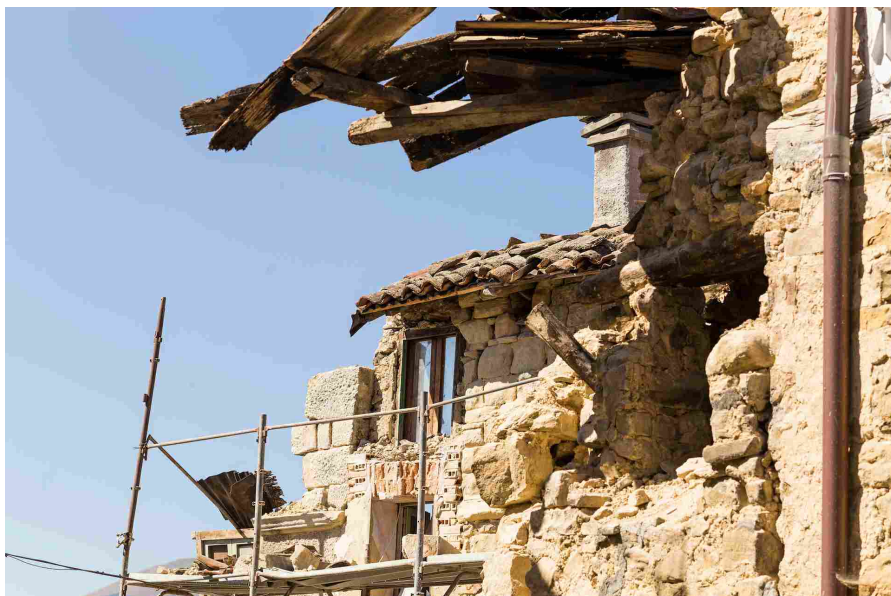
(Edifici in muratura ad Amatrice gravemente danneggiati dal terremoto del 2016. Foto Adobe Stock)
