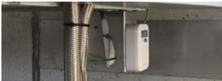
Sensori di spostamento a tecnologia radar per la misura dello spostamento relativo di ciascun piede metallico rispetto alla corrispondente pila (immagine fornita da CETENA).
