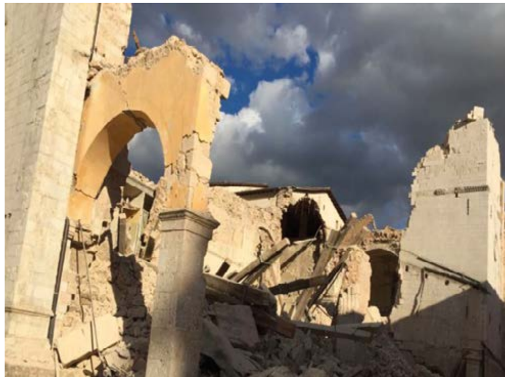
Basilica di San Benedetto dopo il terremoto
